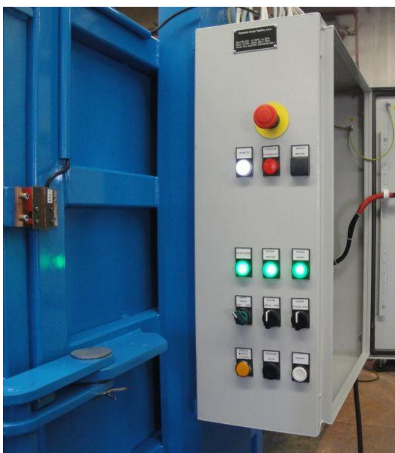
Ovládací prvky na boku rozvaděče
