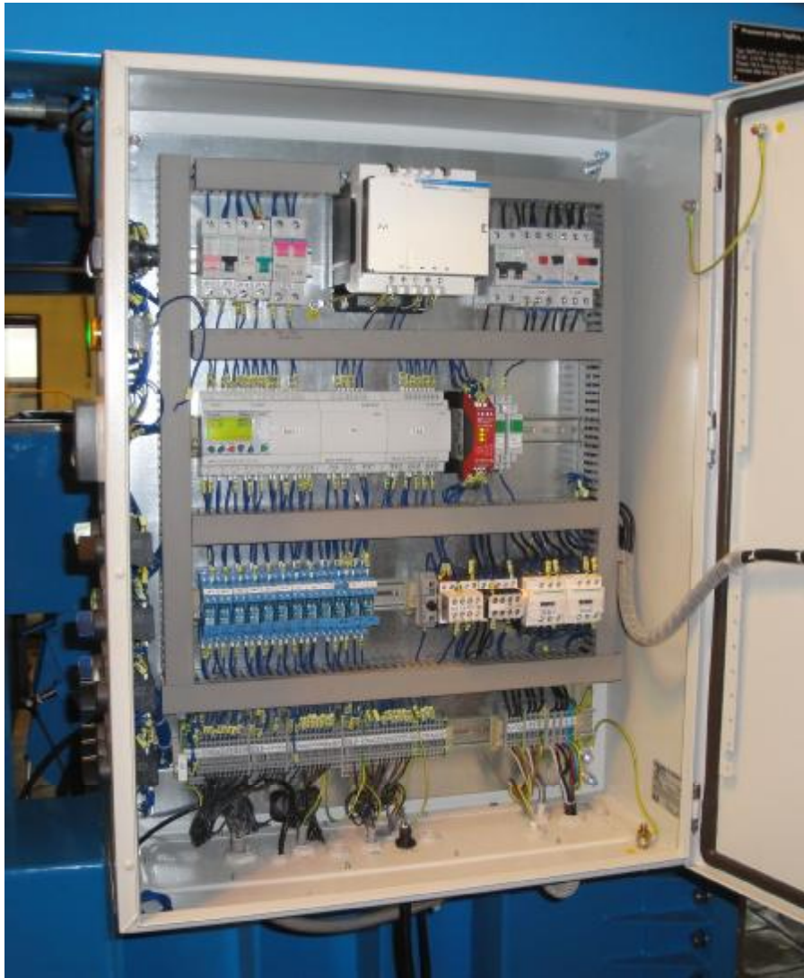
Provedení elektrického rozvaděče
