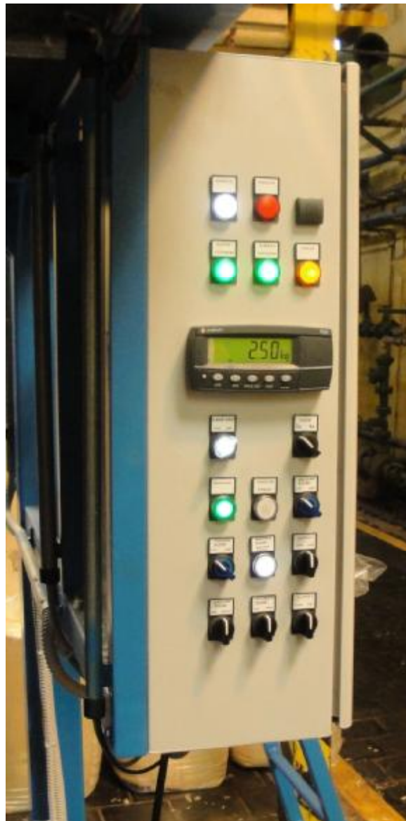
Ovládaní zařízení na boku elektrického rozvaděče.
