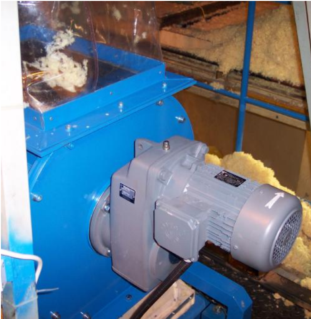
Detail připojení rotačního podavače průsvitnou folií na výstup cyklonu.
